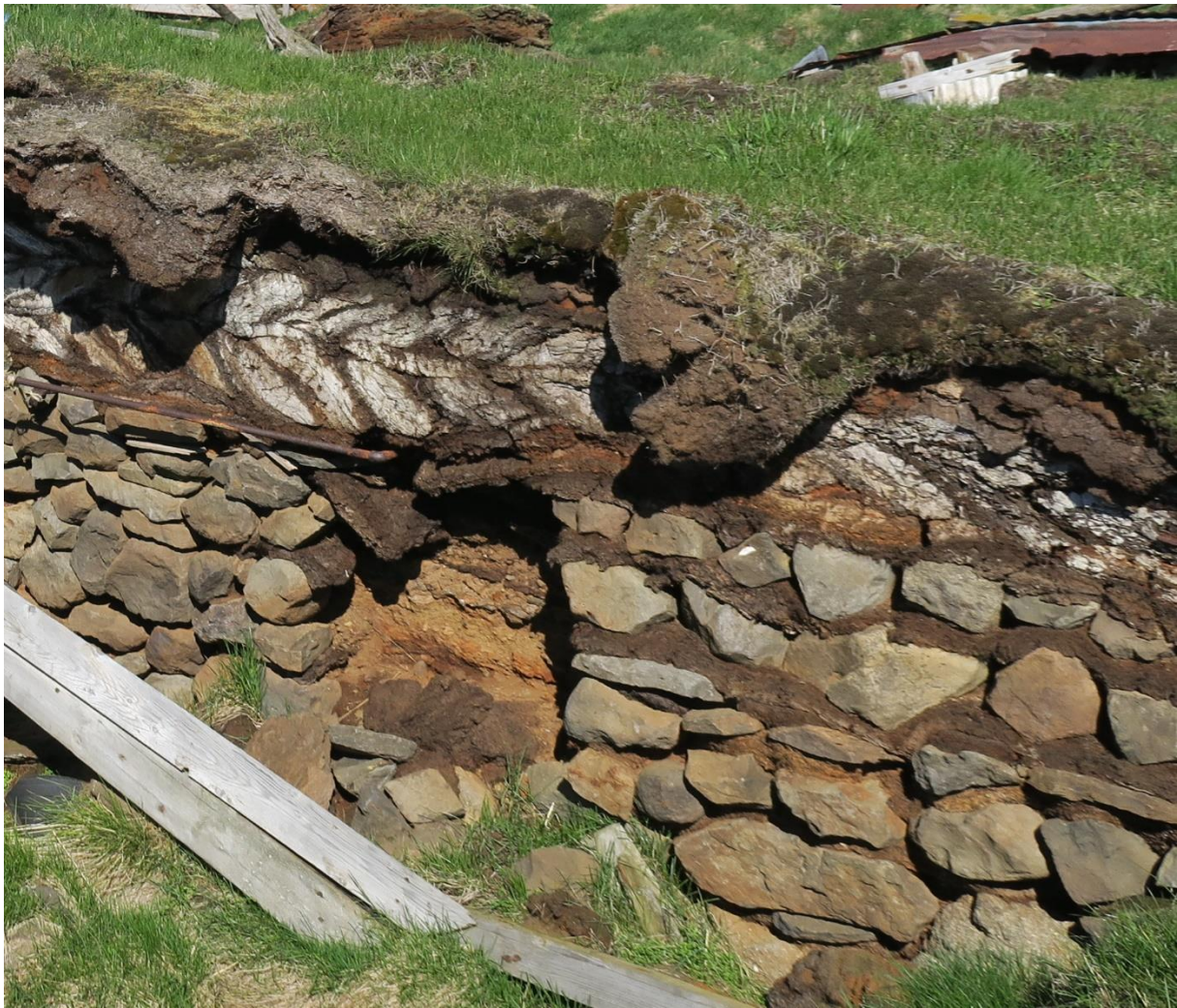
Mynd 84. Hér er hluti innveggjar dottinn í burtu. Veggur með grjóthleðslu í streng næstum alla veggghæðina. Efstu hleðslulögin eru úr klömbru og streng. Í gatinu, sem myndaðist þegar innri hleðslan datt burtu, sést vel í fyllinguna. Jarðvegurinn utan við húsinn var eitthvað hærri en gólfið í fjárhúsunum sem gæti hafa valdið þrýstingi á vegginn en í þessu tilviki er sökudólgurinn vatnsrörið sem leitt hefur verið í gegn um vegginn. Sennilega hefur þarna dottið uppgilding úr veggnum sem hefur verið gerð þegar vatnið var leitt inn/Ljósm.BZ-2018.
