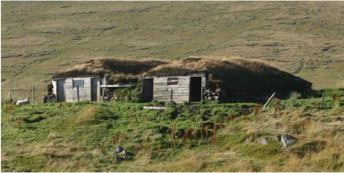
Mynd 85. Fjárhúsin á Ytra-Vatni í september 2004. Þarna voru húsin enn í nothæfu ástandi skv. Byggðasögu Skagafjarðar (III. bindi, bls. 502). Til vinstri má sjá báðar hurðarnar og gler í glugga. Glerið er aftur á móti ekki í glugganum á húsunum til hægri. Ljósmynd: Hjalti Pálsson.
